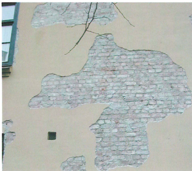
Nedfall av puss.
