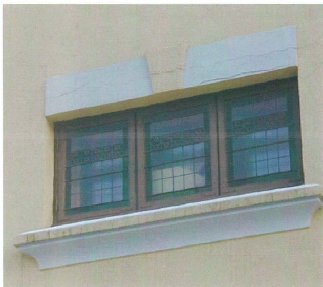
Sprekk over vindu forårsaket av innmurt bjelke som korroderer.
