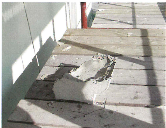
Nedfall av løs betong
