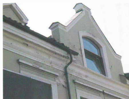
Skader fra ødelagte takrenner.
