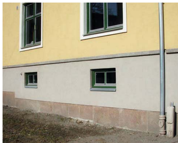
Bilde 6.4.12 Nedløp må tilpasses dreneringsystem
