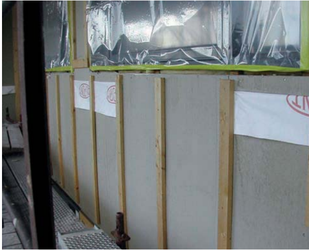
Bilde 6.4.16 Utlekking for luftet kledning under lange vinduer
