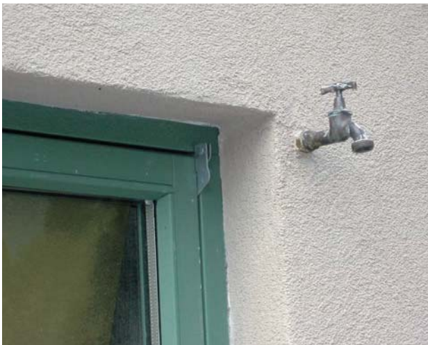
Bilde 6.4.9 Rør til utekraner må forlenges
