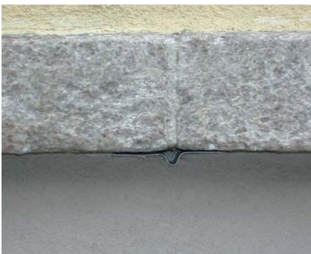
Bilde 6.4.11 Avrenningsbeslag under stussfuger i fremstikkende granittsokkel hindrer vann i å trenge ned i underliggende isolasjon
