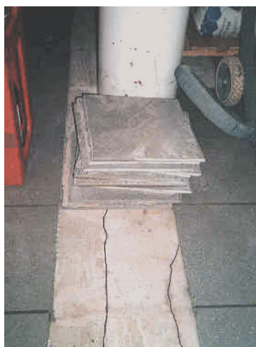
Figur 2.3.4: Oppsprekking i fliser fra enderotasjon
