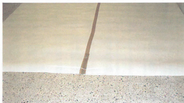
Bilde 4: Etter at gulvet er ferdig lagt skal det tildekkes og beskyttes mot trafikk i minimum 1–3 døgn.
